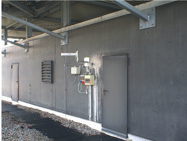
Abbildung G.5: Der Antennenstandort an Gebäude 14
