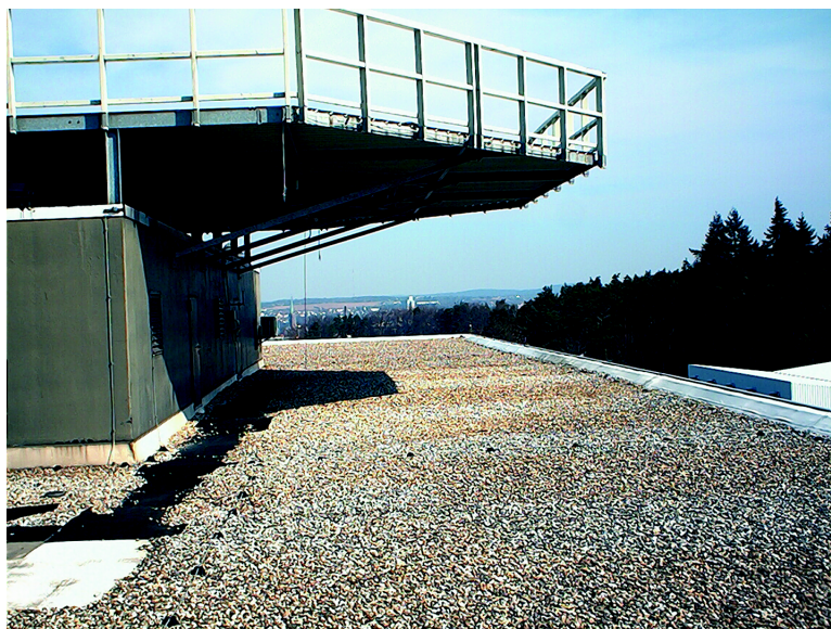
Abbildung G.6: Meßplattform auf Gebäude 14
