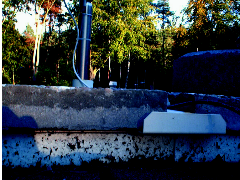
Abbildung G.13: Seitenansicht des Antennenhalters auf Gebäude 7
